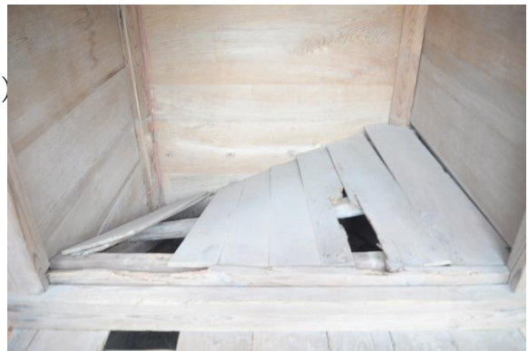
図 2 床組破損状況
