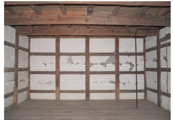
図2 一階壁のひび割れ状況
