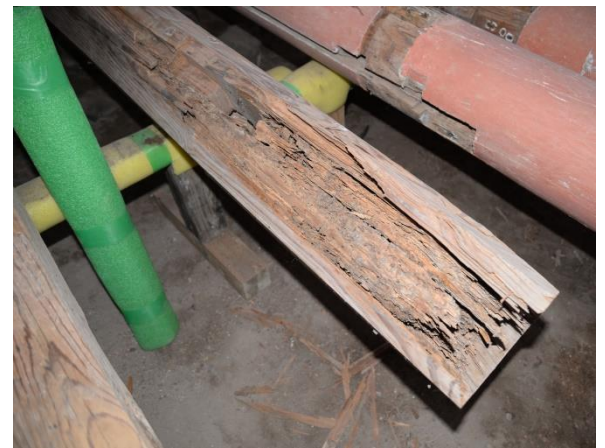
図 2 白蟻により柱の芯が喰われていた。
