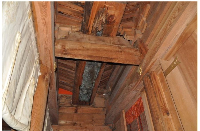
図2 造合西側樋 破損状況
