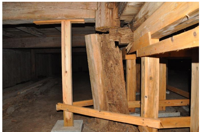
図3 床下 柱の蟻害状況
